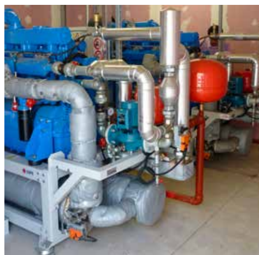
Impianto di cogenerazione da 98 kW elettrici e 220 kW termici Azienda agricola florovivaistica - Due Carrare (PD)
