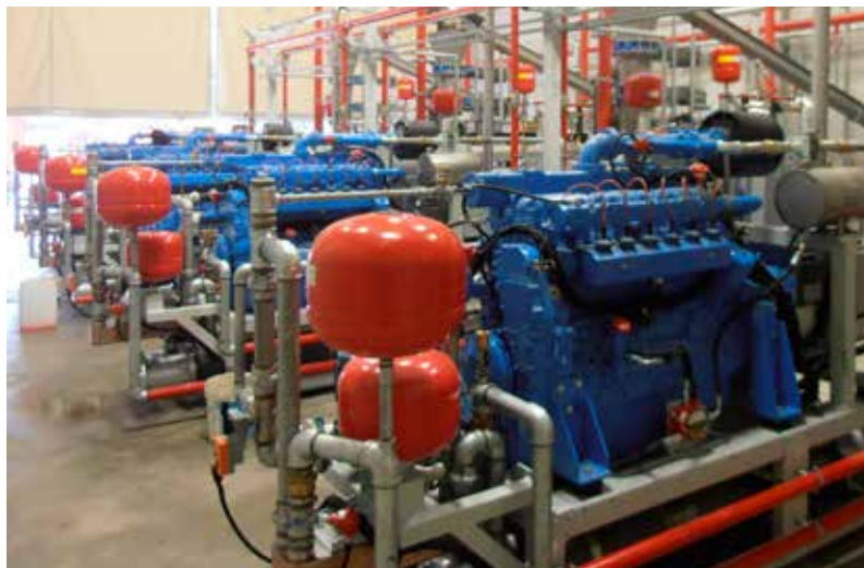
Impianto di cogenerazione da 196 kW elettrici e 440 kW termici Azienda di produzione di cippato - Valdastico (VI)
