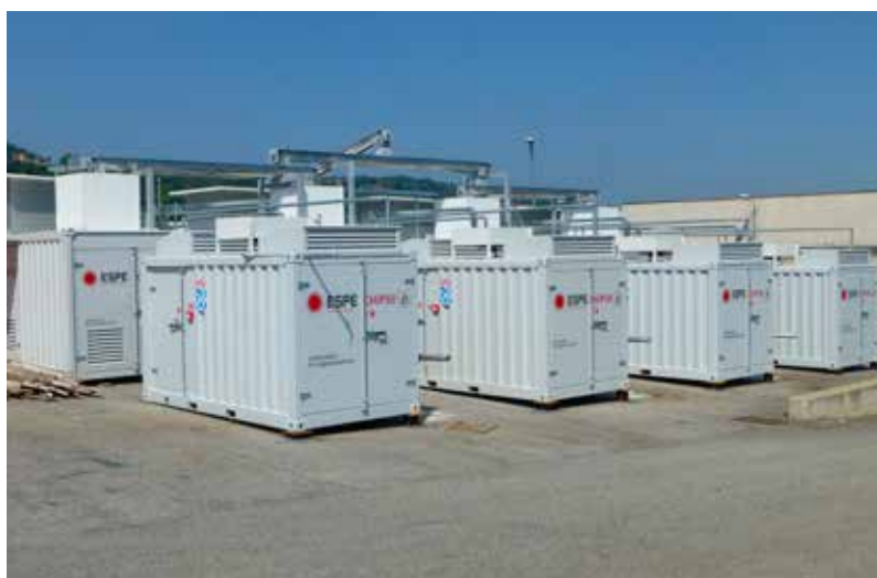
Impianto di cogenerazione da 196 kW elettrici e 440 kW termici Azienda produttrice di macchine utensili - Manta (CN)
