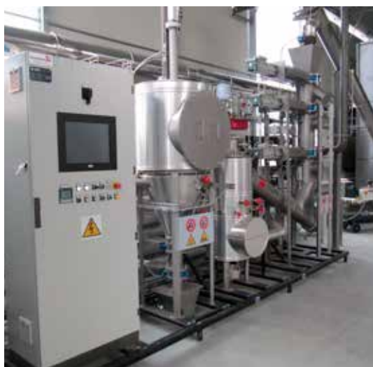
Potenza 49 kW e e 110 kW t , azienda ortofrutticola Castel San Giovanni (PC)
